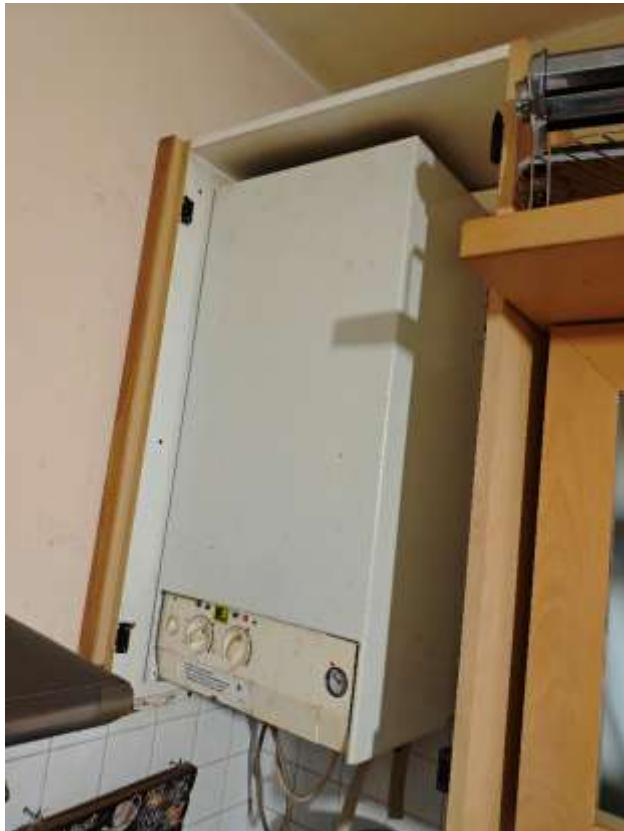
FOTO 16 Generatore di calore impianto termico (1)
